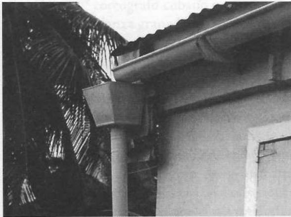
Detalle del sistema colector de agua de lluvia. Carriacou, 1983. Foto Carlos Manuel Fernández, archivo Cidmuc.
