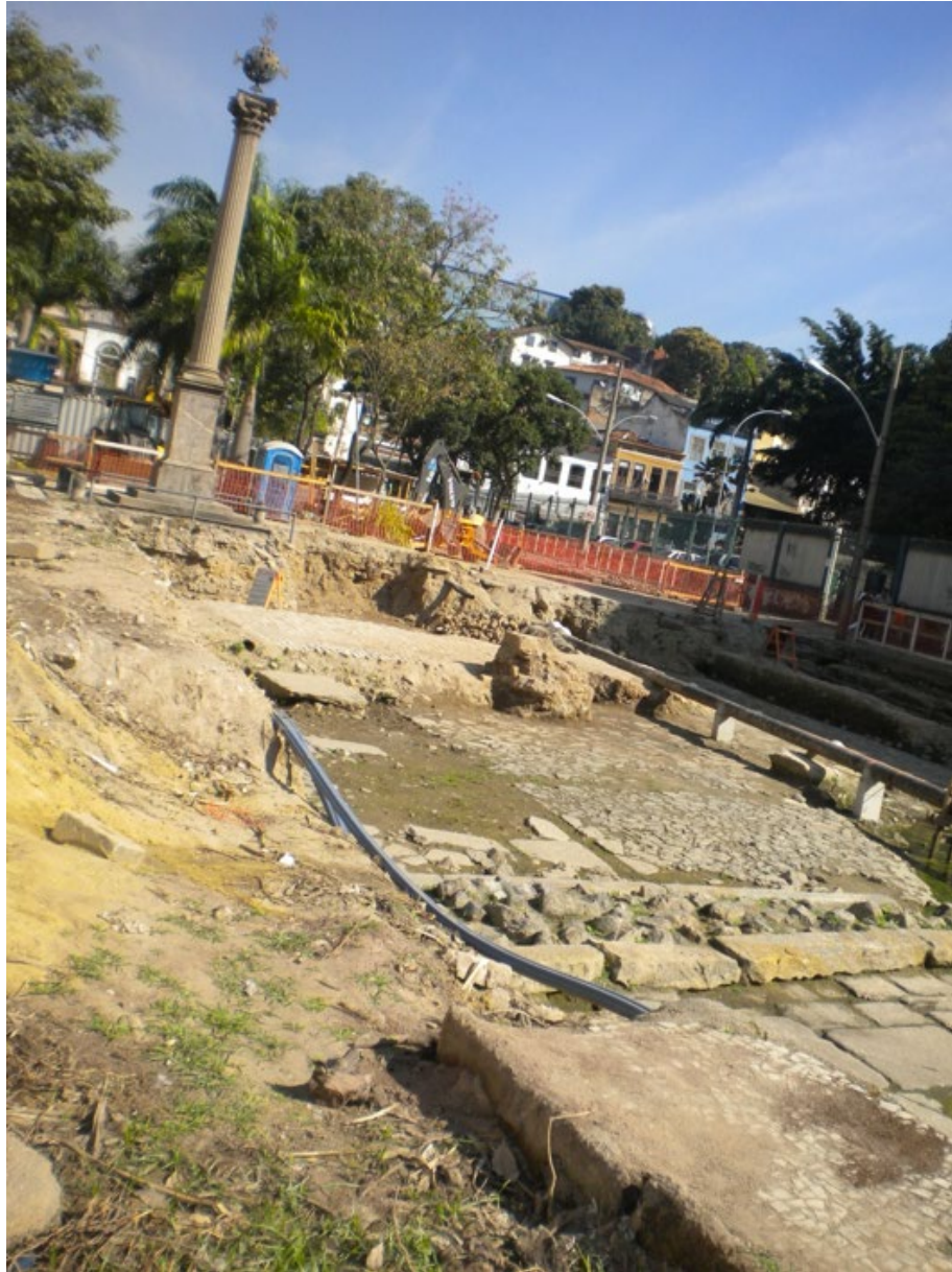
Illustration 38 : Quais du Valongo et de l'Impératrice juste après leur excavation en 2011. Photographie de Simone Pondé Vassallo. ■
